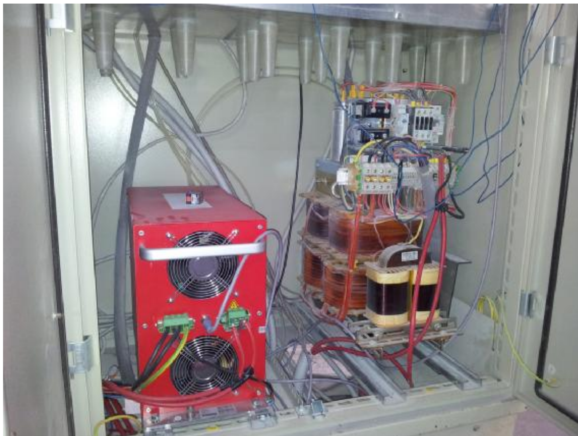
Устройство Phaser EVO 21/2000 мощностью 21 кВт заменяет один из двух трансформаторов в компании Bürkle.
