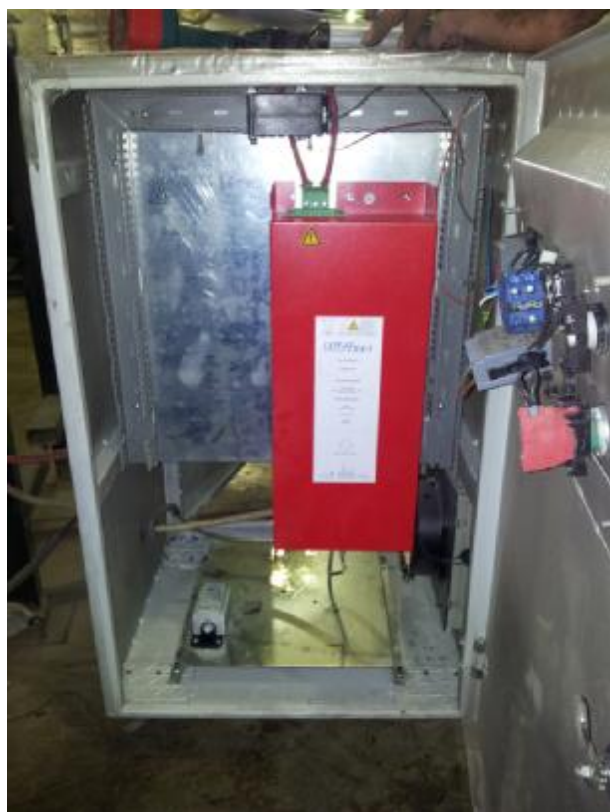
Устройство Phaser EVO 5/450 мощностью 5 кВт установлено вместо трансформатора.
