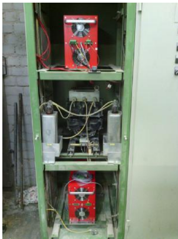
Замена двух из трех трансформаторов двумя устройствами Phaser EVO 21/1900 мощностью 21 кВт.
